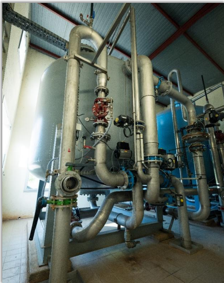
Usine de potabilisation à Castelnaudary
