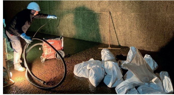
Usine de potabilisation de Sainte Marie à Castelnaudary
